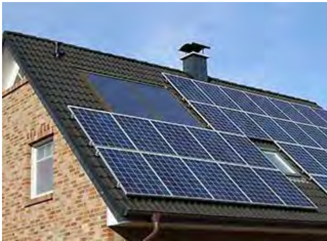
Figure 14 : Panneau solaire photovoltaïque sur toiture
